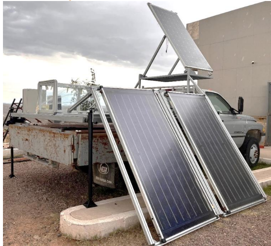
Figura 4. Integración del sistema en la plataforma desmontable. Fuente: Propia.
